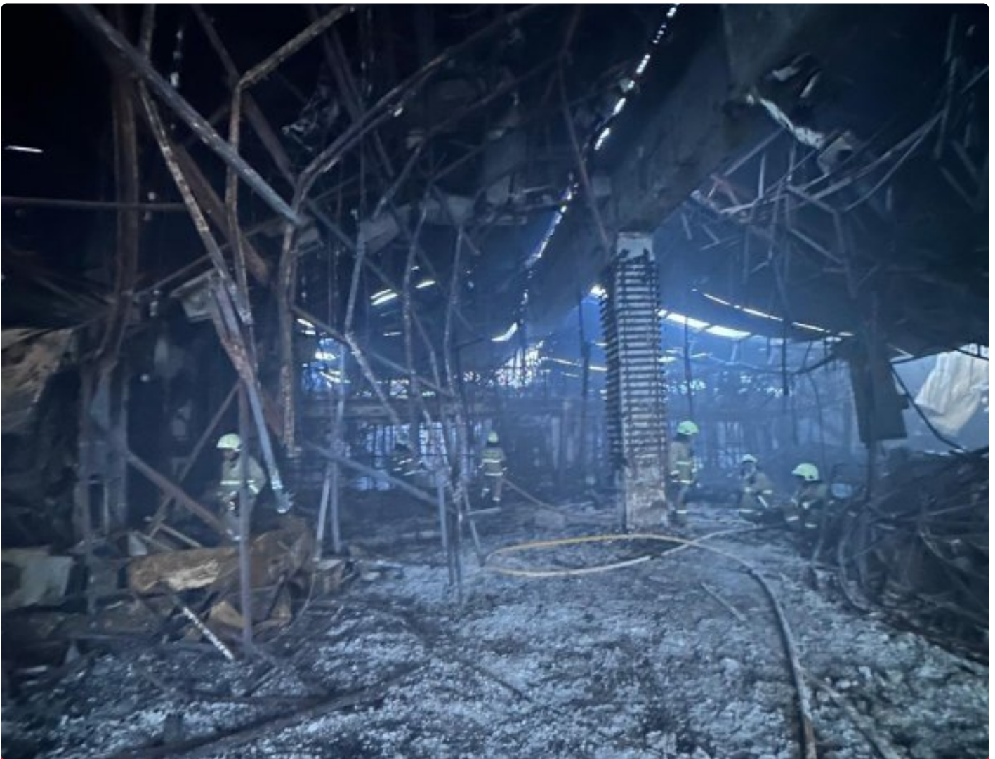
Glodok Plaza yang Hangus Terbakar
